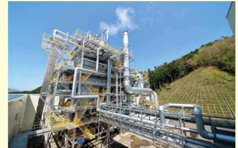
バイオマス発電所
