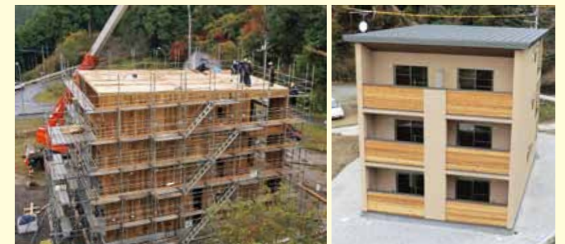
木造ビルディング(おおとよ製材社員寮) 左:建設中 右:完成
