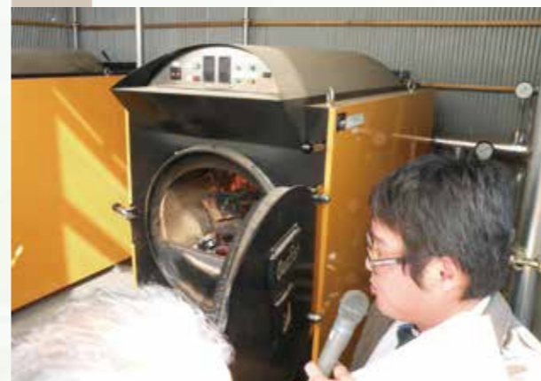
津黒高原荘に導入されている薪ボイラー
