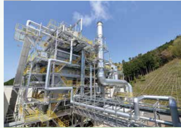
真庭バイオマス発電所
